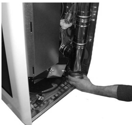
Fig. 102 - Pulizia canale da fumo
